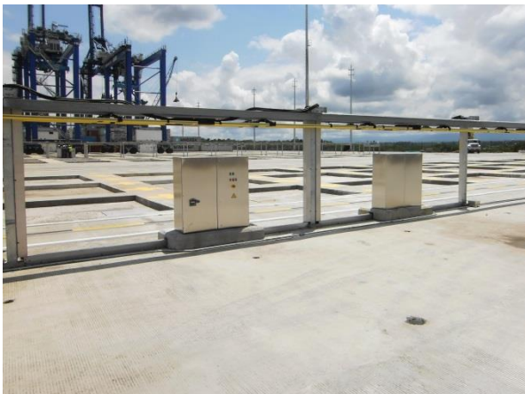
BU: Die Einspeisemodule im Hafen Buenaventura für die Schleifleitungssysteme in der back-to-back Anordnung.
