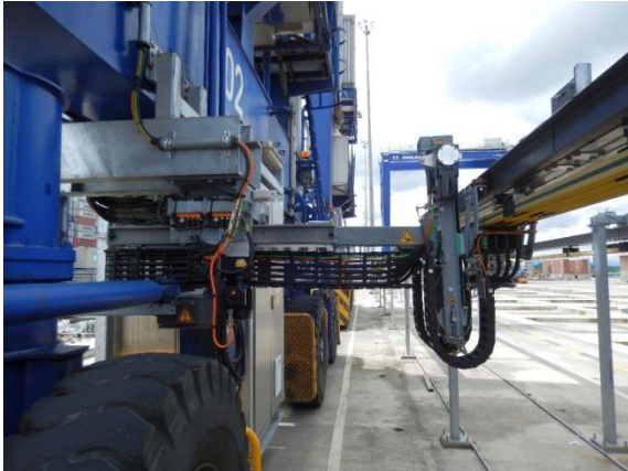
BU: Ein E-RTG mit Drive-In L-Unit, verbunden mit dem Schleifleitungssystem.
